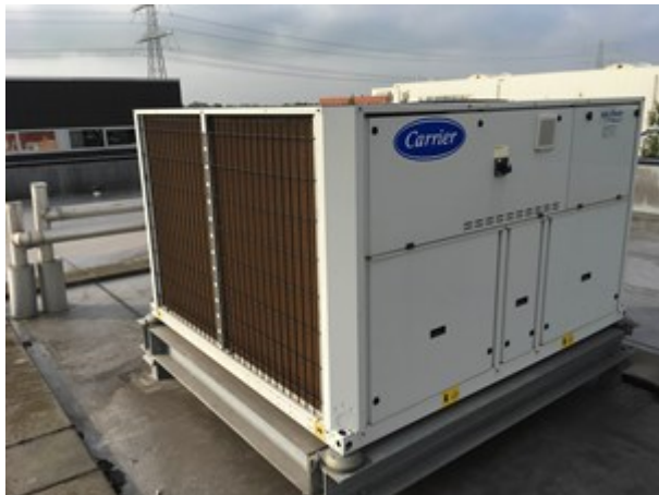
Afb. 10.16 Compressiekoelmachine met distributieleidingen
