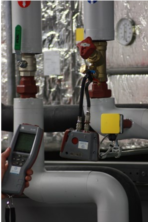
Afb. 9.53 Inregelafsluiter (afsluiter met rode handbediening)
