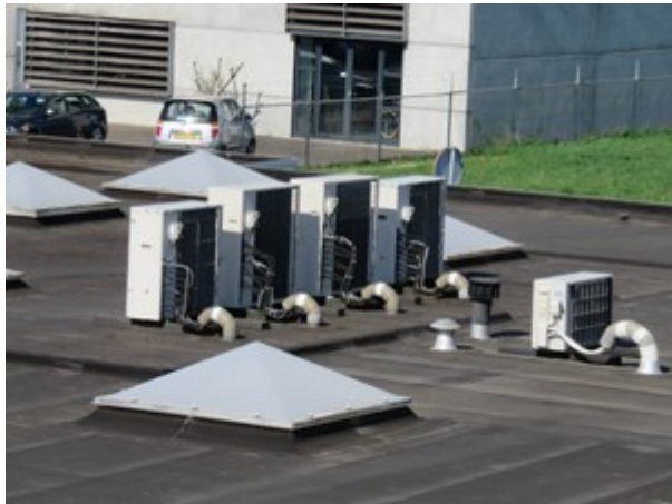
Afb. 10.9 Buitenunit van een splitsysteem op een dak (condensor)
