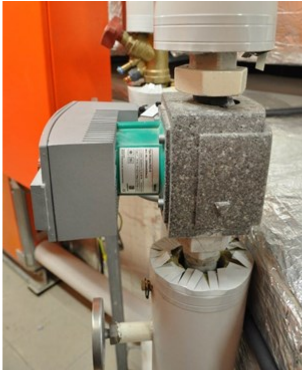
Afb. 13.10 Isolatie van leidingen en circulatiepomp
