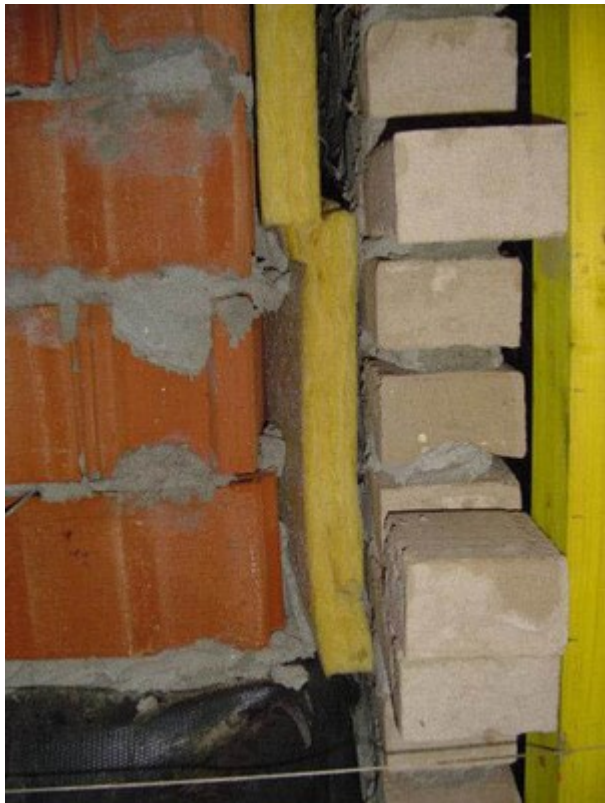
Afb. 8.43 Isolatiemateriaal sluit onderling niet goed op elkaar aan
