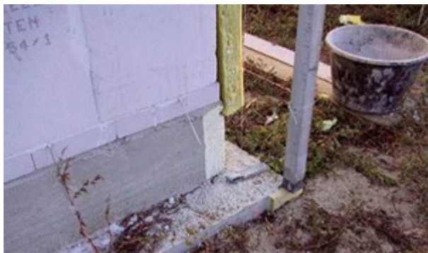
Afb. 8.40 Isolatiemateriaal sluit niet goed aan op de omliggende constructies
