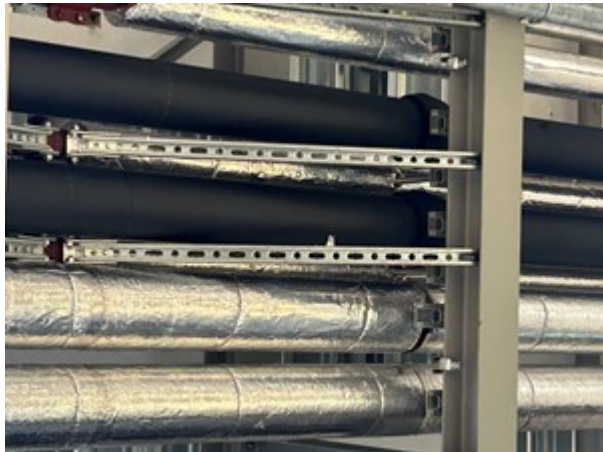
Afb. 9.57 Isolatie leidingen verwarming (linker twee leidingen)
