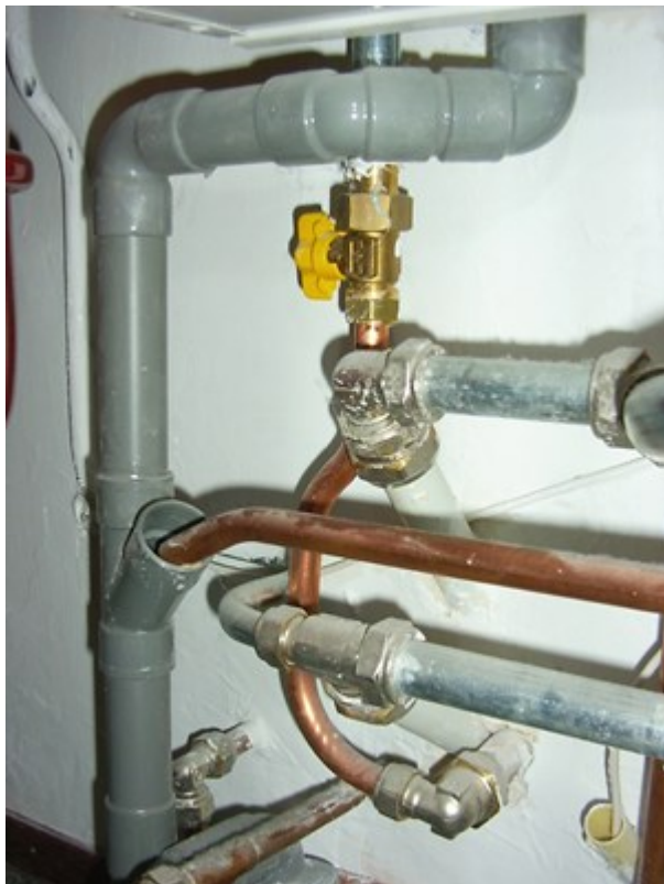
Afb. 9.16 Condensatafvoer onder CV-ketel, kenmerkend voor HR-ketels
