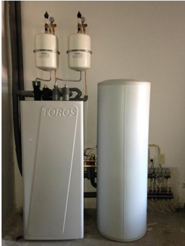
Afb. 10.18 Bodemwarmtepomp met boilervat
