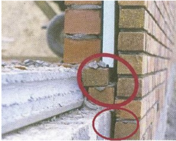
Afb. 8.39 Isolatiemateriaal niet goed doorgezet waardoor er een koudebrug ontstaat (bron: Nieman)
