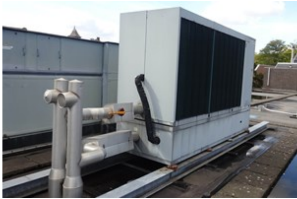
Afb. 10.15 Compressiekoelmachine met distributieleidingen
