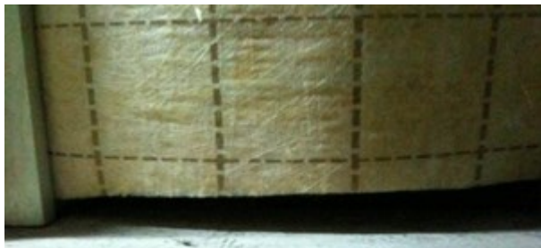
Afb. 8.41 Isolatiemateriaal sluit niet goed aan op de vloer (bron: Nieman)
