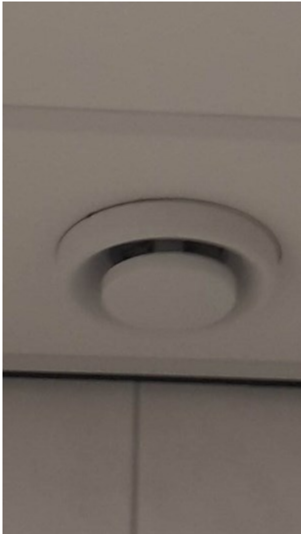
Afb. 11.16 Een afzuigventiel van mechanische ventilatie
