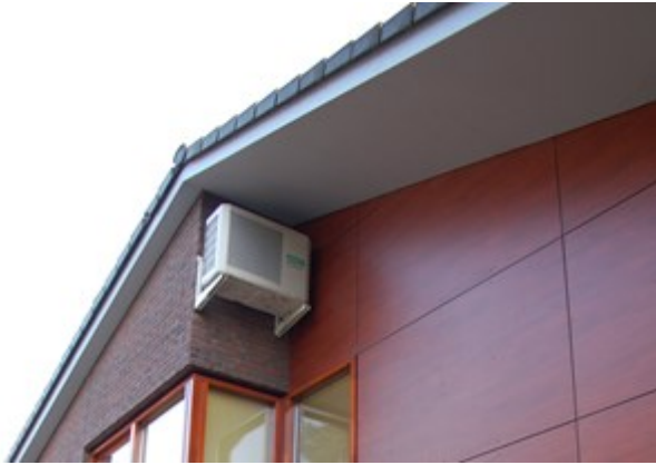
Afb. 10.8 Buitenunit van lokale koeling
