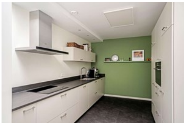
Afb. 9.38 Infraroodpaneel in de keuken, aan het plafond gemonteerd
