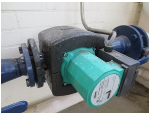
Afb. 10.25 Isolatie van leidingen en een geïsoleerde pomp
