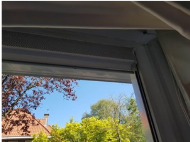
Afb. 11.4 Ventilatie-rooster boven raam
