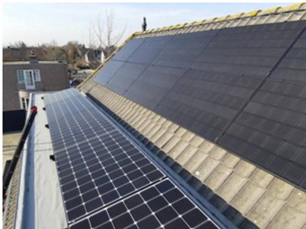
Afb. 15.5 Monokristallijne panelen (zowel de rij links op de foto als rechts op de foto zijn monokristallijne panelen) (bron: Zonnepanelen Xtra BV)
