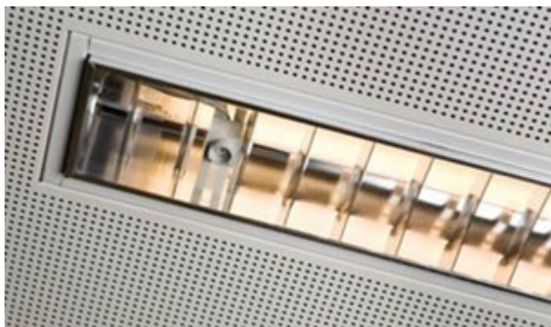
Afb. 14.12 TL-armatuur met sensor voor daglichtregeling op de TL-buis gemonteerd
