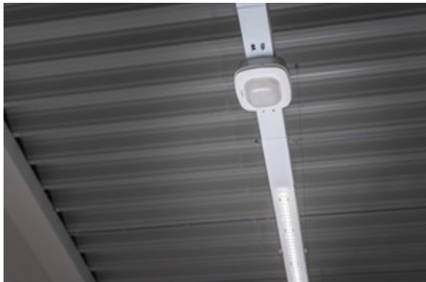
Afb. 14.3 Verlichting met aanwezigheidssensor (bron: Trilux)
