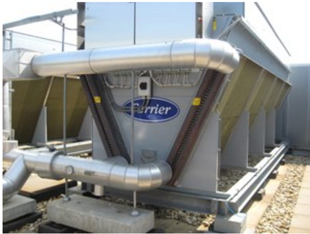
Afb. 10.13 Luchtgekoelde condensor (drycooler) (bron: Carrier)
