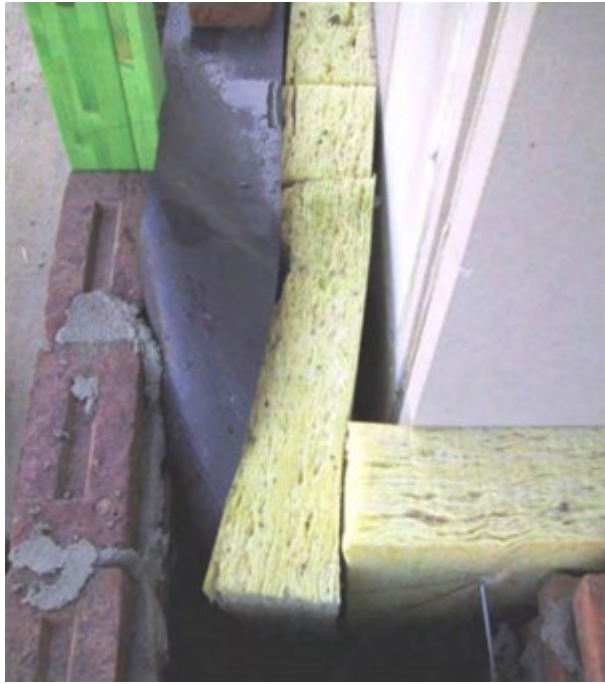
Afb. 8.42 Isolatiematerialen sluiten niet goed aan, hierdoor ontstaat een open hoek (bron: Nieman)
