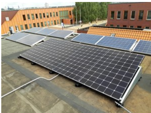
Afb. 15.6 Monokristallijne panelen met daarachter nog polykristallijne zonnepanelen (bron: Zonnepanelen Xtra BV)
