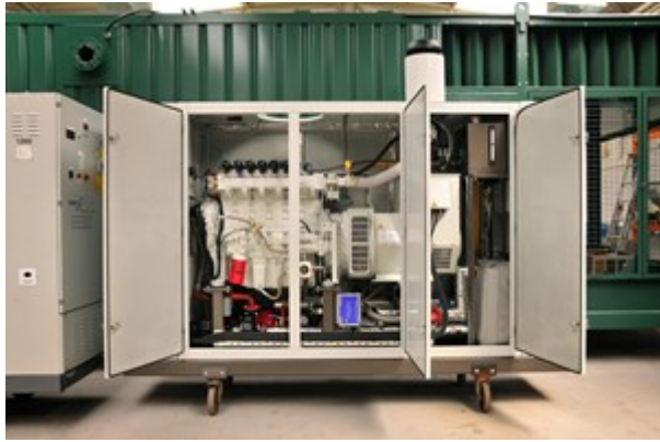
Afb. 9.26 WKK met links (vanaf het midden) in de kast de motor
