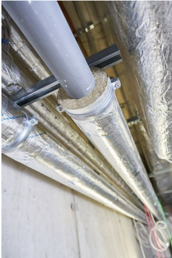
Afb. 9.56 Isolatie leidingen verwarming
