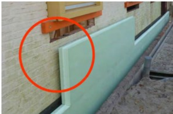
Afb. 8.45 Isolatiemateriaal sluit niet goed aan op het binnenblad van de gevel (bron: Nieman)
