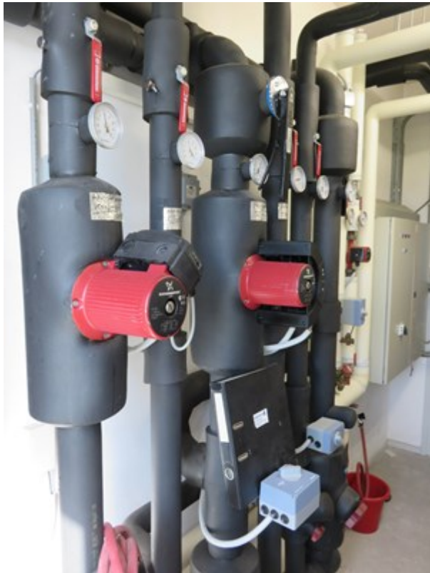
Afb. 10.26 Verdeler van koelinstallatie met geïsoleerde leidingen en appendages
